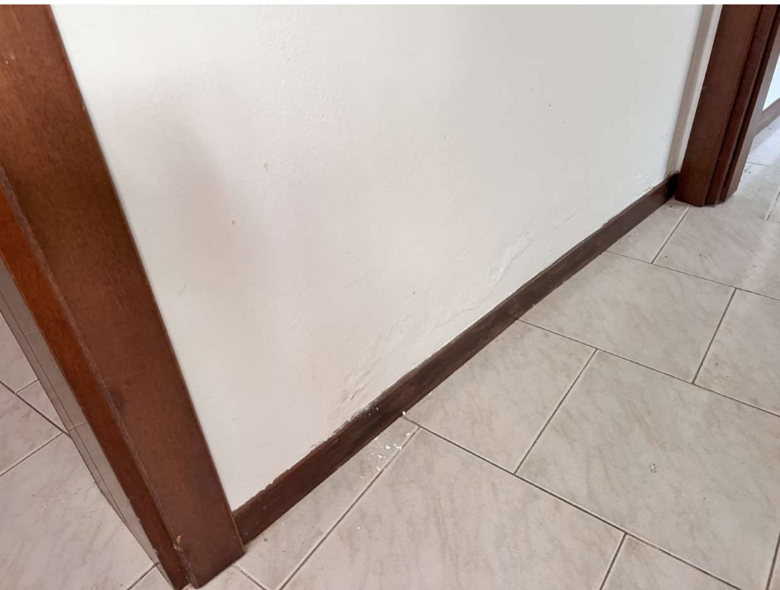
PARTICOLARE EFFLORESCENZE SALINE NEL DISIMPEGNO NOTTE DELL'ABITAZIONE AL PIANO TERRENO
